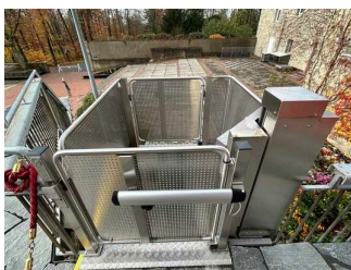
Weg zum Haupteingang (Teil 3): Hublift im Außenbereich
